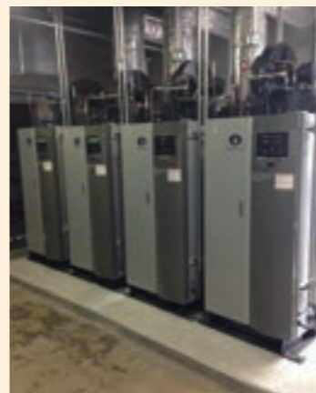
高性能小型ボイラ4台
