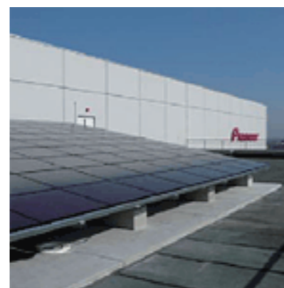
川崎事業所に導入した太陽光発電装置
