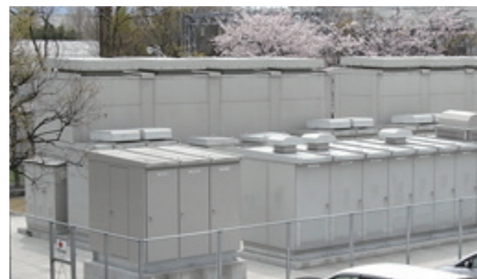
パイオニアマイクロテクノロジーに導入された NaS 電池
