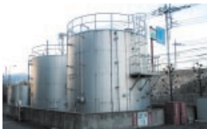
重油タンクの防液堤（パイオニアマイクロテクノロジー（株））
